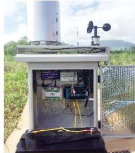
Hình 5. Tủ thiết bị IoT
